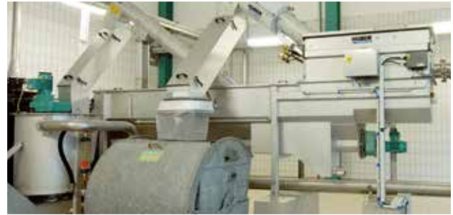
Bewährte Vorreinigungskomponenten vereint in der HUBER Fäkalannahmestation ROTAMAT® Ro 3.3.
