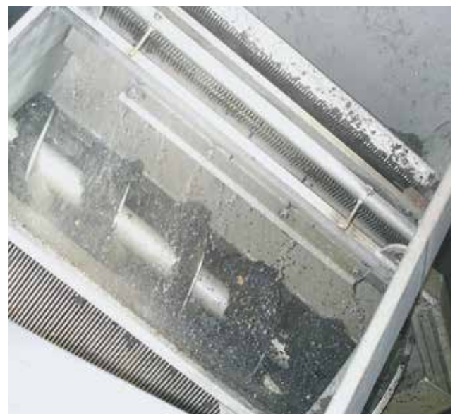
Im Rechenkorb werden Schwimm- und Schwebestoffe effektiv zurückgehalten. Durch die durchgreifenden Rechenzähne erfolgt eine Zwangsreinigung des Rechenkorbes.
