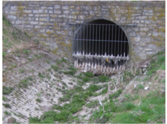
Typisches Bild eines Regenauslassbauwerkes ohne Grobstoffrückhalt nach einem Entlastungsereignis.
