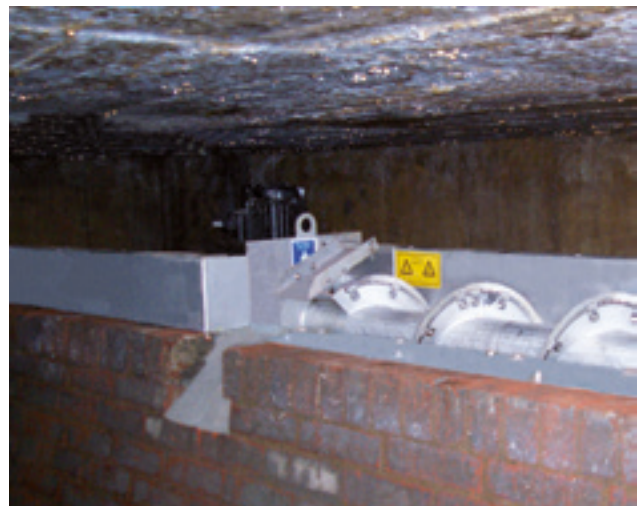
Standardmäßige Siebgutrückführung in den Abwasserkanal mit einer Auswerferklappe.
