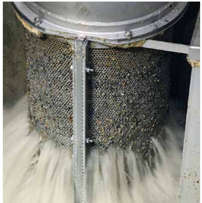
„Im Betrieb befindliche HUBER Schachtsiebanlage ROTAMAT® RoK4.“
