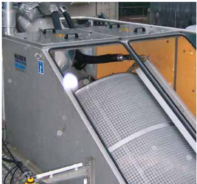
Installation im Freien mit Abdeckung und wärmege-dämmter Spritzwasserleitung.
