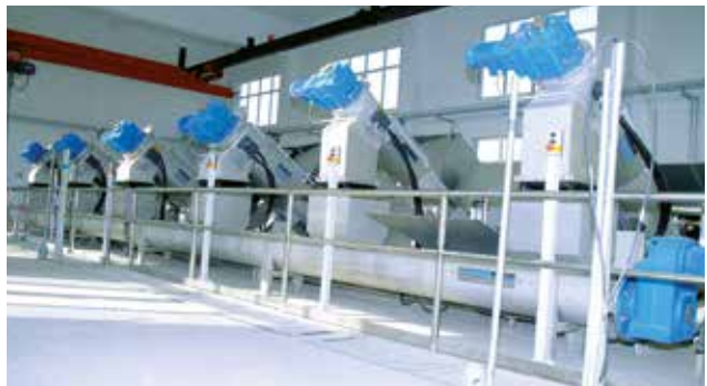
Zum Schutz einer großen Membran-Beliebungsanlage installierte HUBER Membrane Screen ROTAMAT® RoMem.
