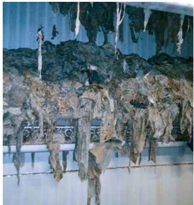
Abbildung 3: Hohe Schmutzstofffracht auf einem Harkenbalken.
