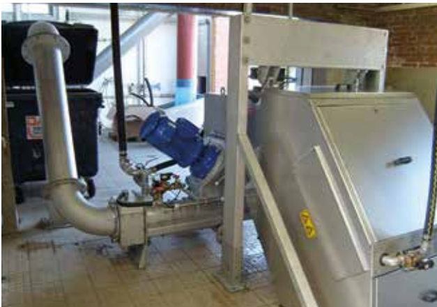
HUBER Stufenrechen STEP SCREEN® Flexible in Kombination mit der HUBER Waschpresse WAP® SL für eine intensive Rechengutauswaschung in komplett geruchsgedampelter Ausführung.
