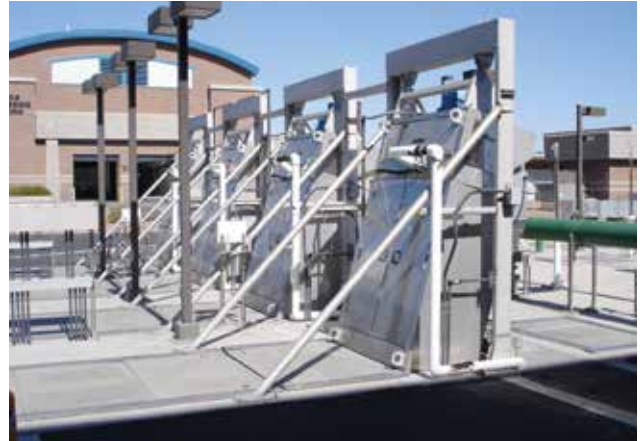
Vier HUBER Stufenrechen STEP SCREEN® SSV: Länge 5300, Breite 1376, Spaltweite 6 mm, Aufstellwinkel 75°. Höchste Betriebsstabilität durch speziell ausgebildete Bodenstufe zur Steigerung der Unempfindlichkeit gegenüber Sand, Splitt und Steinen.
