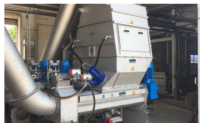
Das hydraulische Hochdruckpressteil am Ende der Waschpresse garantiert höchste TR-Werte.
