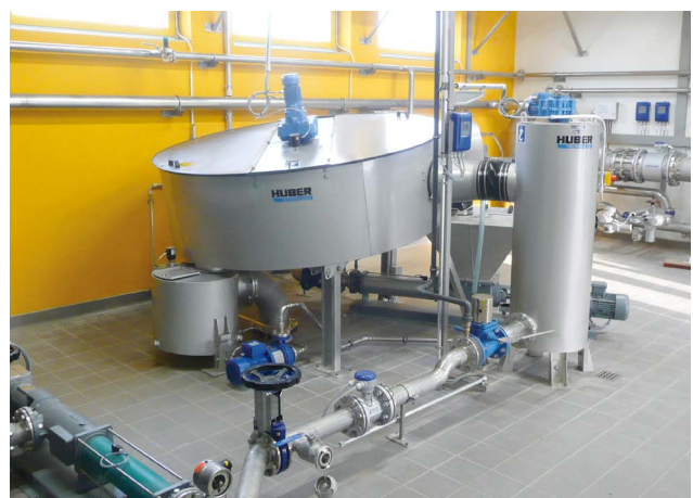
Filtratvorlage und Spritzwasserpumpe für Wasserkreislauf.
