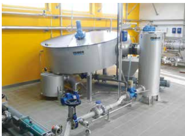
Filtratvorlage und Spritzwasserpumpe für Wasserkreislauf.
