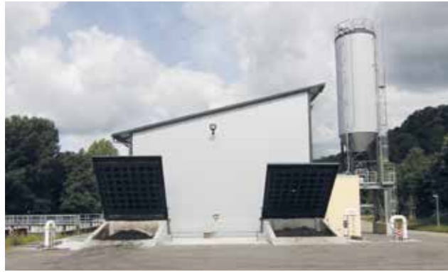
Annahmehunker und Trockengutsilo.
