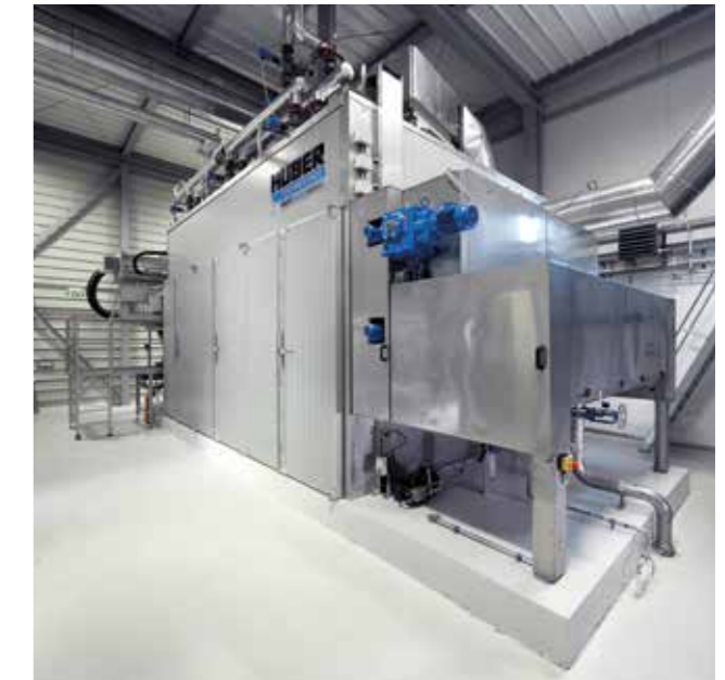
Kopfstück mit integrierter, automatischer Bandreinigung.
