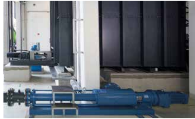
Schlammhunker mit Schlammpumpe.
