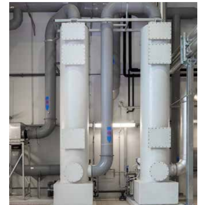
Zweistufiger Wäscher zur Abluftbehandlung Zweistufiger Wäscher zur Abluftbehandlung.
