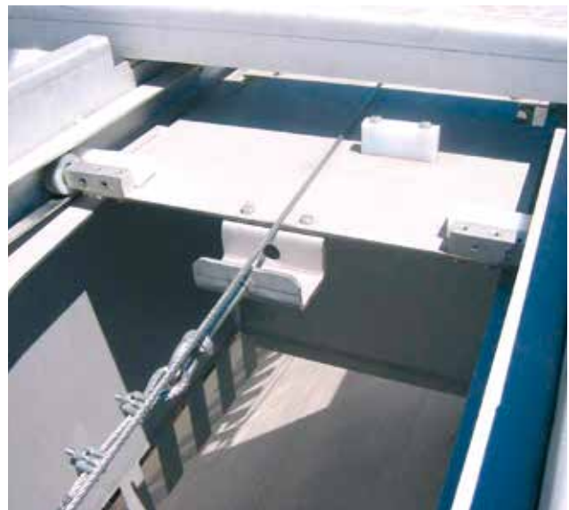
Automatische Fetträumung mittels Fettpaddel.
