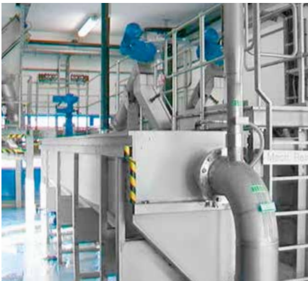
Oberirdische, redundante HUBER Langsandfänge ROTAMAT® Ro6.
