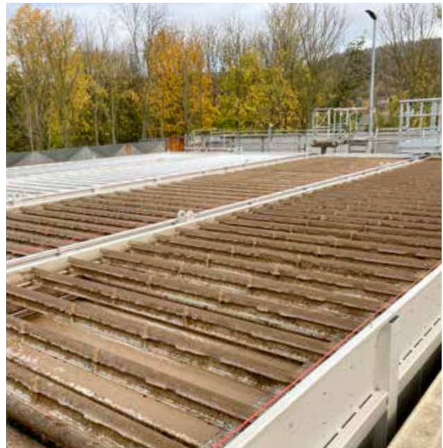
HUBER Drucktensionsflotationen mit chemischer Stufe zur Nachreinigung – die Lösung zur Entlastung biologischer Behandlungsanlagen.
