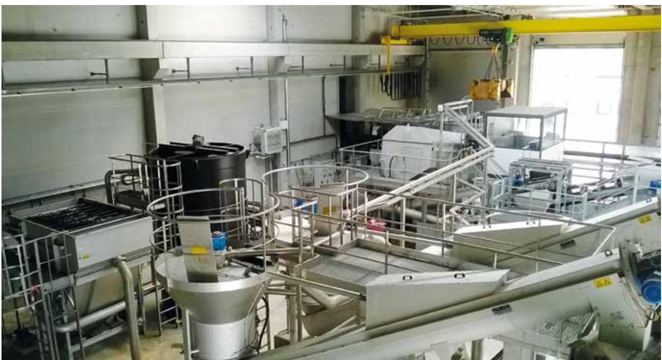
HUBER Sandaufbereitungspumpanlage RoSF5 Malezieux, FR.
