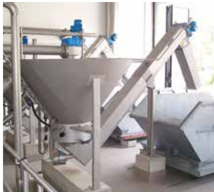
Innovative Technik: HUBER Coanda Sandwaschanlage RoSF4.
