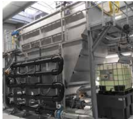
Vielseitige Abwasserreinigung für zahlreiche industrielle Anwendungen.
