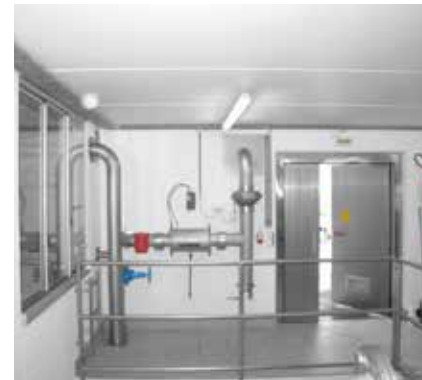
HUBER Komplettsystem der aktiven Zwangsbelüftung.
