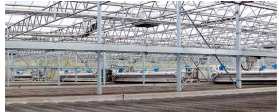
Parallelbetrieb HUBER Schlammwender SOLSTICE®.
