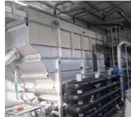
HUBER Druckentspannungsflotation zur Fett und Feststoffreduktion vor Indirekt-einleitung.
