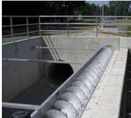
HUBER Siebanlage ROTAMAT® RoK1: Siebung der Entlastungswassermenge nach der Überlaufschwelle.
