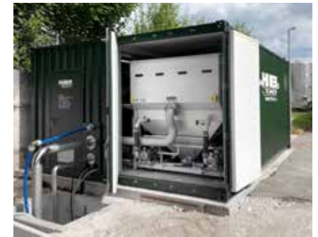
Containeranlage als Permanentinstallation in der Milchindustrie, ca. 35 m³/h Durchsatz.
