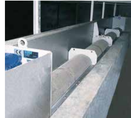
HUBER Siebanlage ROTAMAT® RoK2: Siebung der Entlastungswassermenge vor der Überlaufschwelle.
