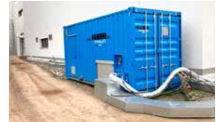
Mietanlage zur Abwasservorreinigung in der Milchindustrie, ca. 15 m³/h Durchsatz.
