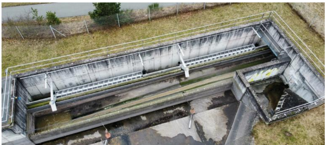
Abbildung 33: Ein Entlastungsbauwerk mit HUBER Siebanlagen ROTAMAT® RoK1 TS, welche auch bei Starkregen in Verbindung mit großen Rechengutmengen betriebssicher funktionieren.
