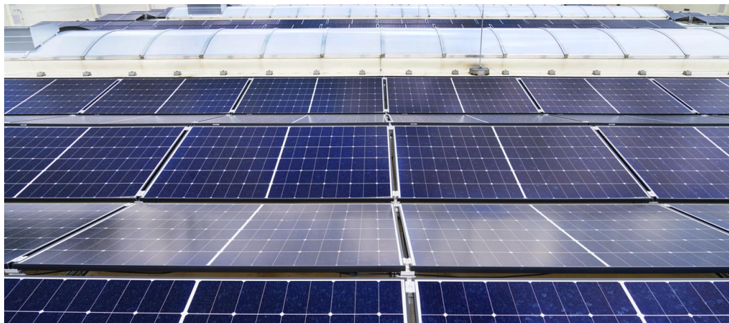
Abbildung 18: Insgesamt sind auf den Dächern der Produktionshallen Solarzellen mit einer Leistung von 1122 kWp installiert.
