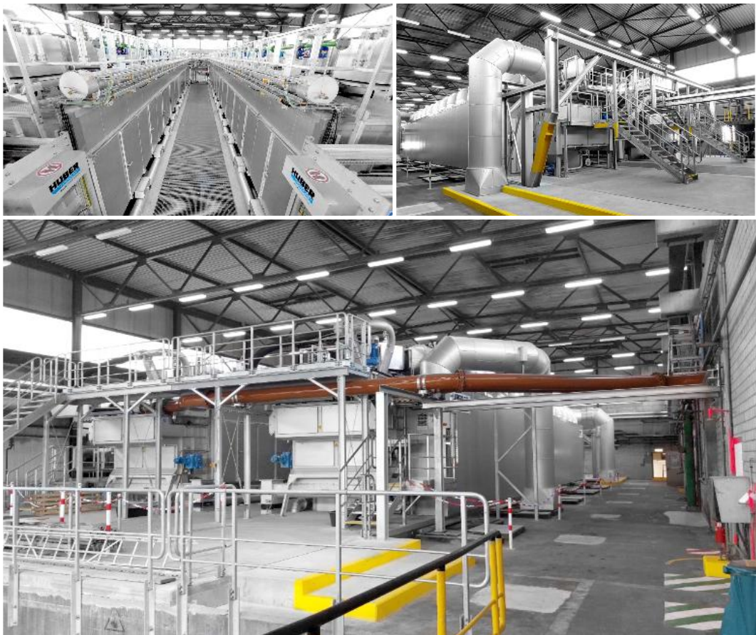
Abbildung 51: HUBER Bandrockner BT installiert bei der BASF in Ludwigshafen. 90.000 Tonnen entwässerter Schlamm werden seit 2023 von 27% TR auf 45% TR getrocknet. Dadurch wird Kohle als Stützbrennstoff für die Klärschlammverbrennung eingespart und mehr als 24.000 Tonnen CO 2 -Emissionen werden vermieden.
