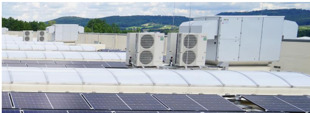
Abbildung 19: Lüftungsanlagen mit Wärmerückgewinnung sowie Wärmepumpentechnik installiert auf dem Dach der Produktionshalle.
