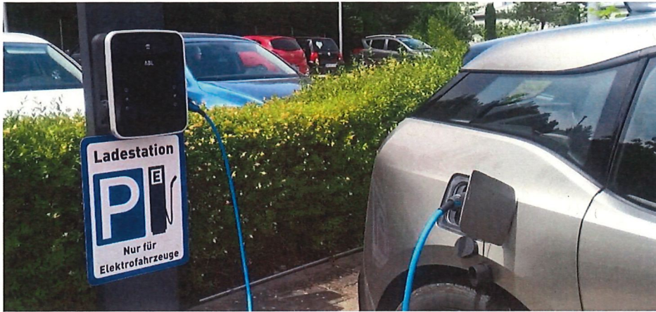
Abbildung 13, Stromtankstellen auf dem Firmengelände. Hier können Kunden aber auch Mitarbeiter ihre Elektrofahrzeuge aufladen
