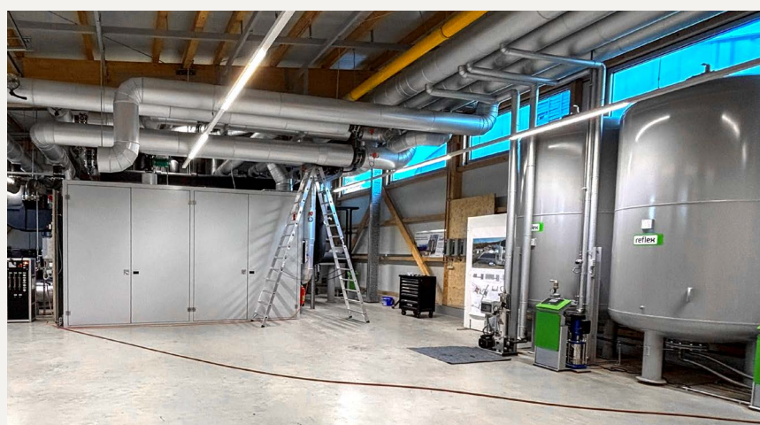
Die Heizungstechnik in der Energiezentrale auf der Kläranlage.
