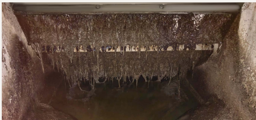
Rückseite eines 3mm-Spaltsieb-Rostes, dessen Oberfläche mit einem Schaber gereinigt wird.
