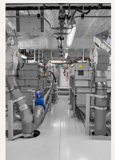
Die zwei HUBER Membrane Screens ROTAMAT® RoMem 1000 wurden umfassend überholt.
