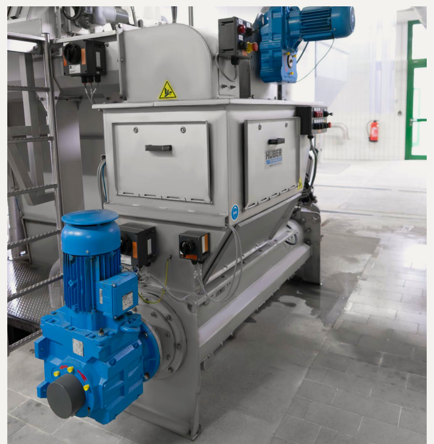
Auf der Kläranlage Neumarkt sind zahlreiche HUBER Anlagen zuverlässig im Einsatz. Verschleißteile bestellt der Betreiber über die HUBER Digital Platform.
