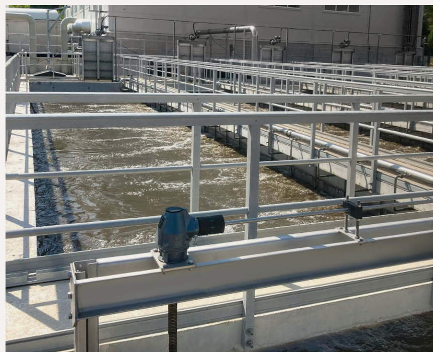
Die Entsandung des Abwassers soll betriebliche Störungen wie Versandung, erhöhten Verschleiß und Verstopfungen verhindern.
