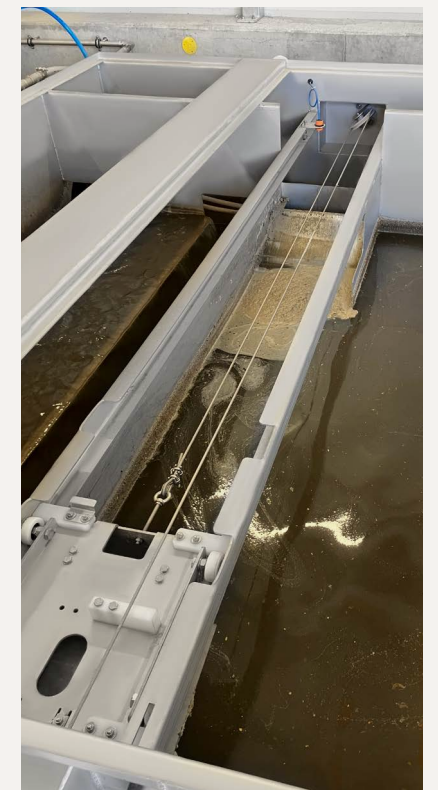
Abbildung 3: Die Schwimmstoffe werden über eine schräge Rampe teilentwässert in einen Fettsammelschacht abgeworfen.
