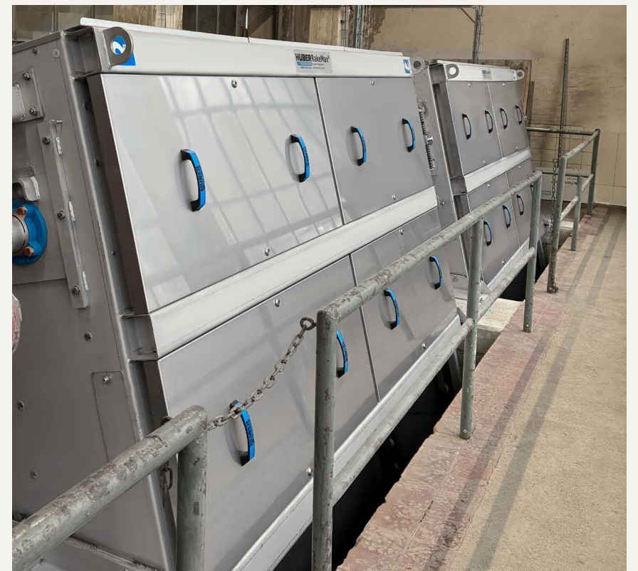
Zwei der vier neuen HUBER Harken-Umlaufrechen RakeMax® im Heizkraftwerk Schwarzta, dem größten Wärmeproduzenten in Thüringen.
