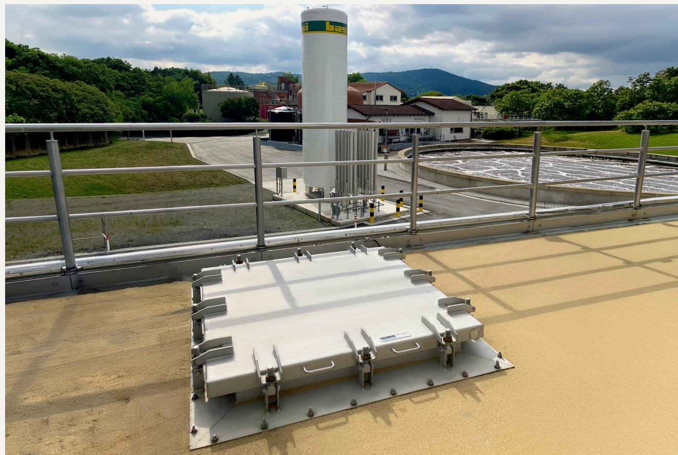
Eine der HUBER Schachtabdeckungen auf der Kläranlage Bickenbach.
