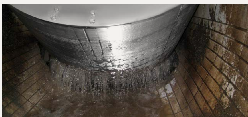
Rückseite einer von Abwasser durchflossenen Siebtrommel – die noch nicht benetzte Fläche ist glänzend sauber.
