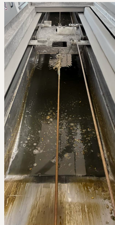
Abbildung 2: Sichere Entnahme mittels Paddelräumer bei der HUBER Kompaktanlage Hydro Duct ROTAMAT® Ro5 HD.
