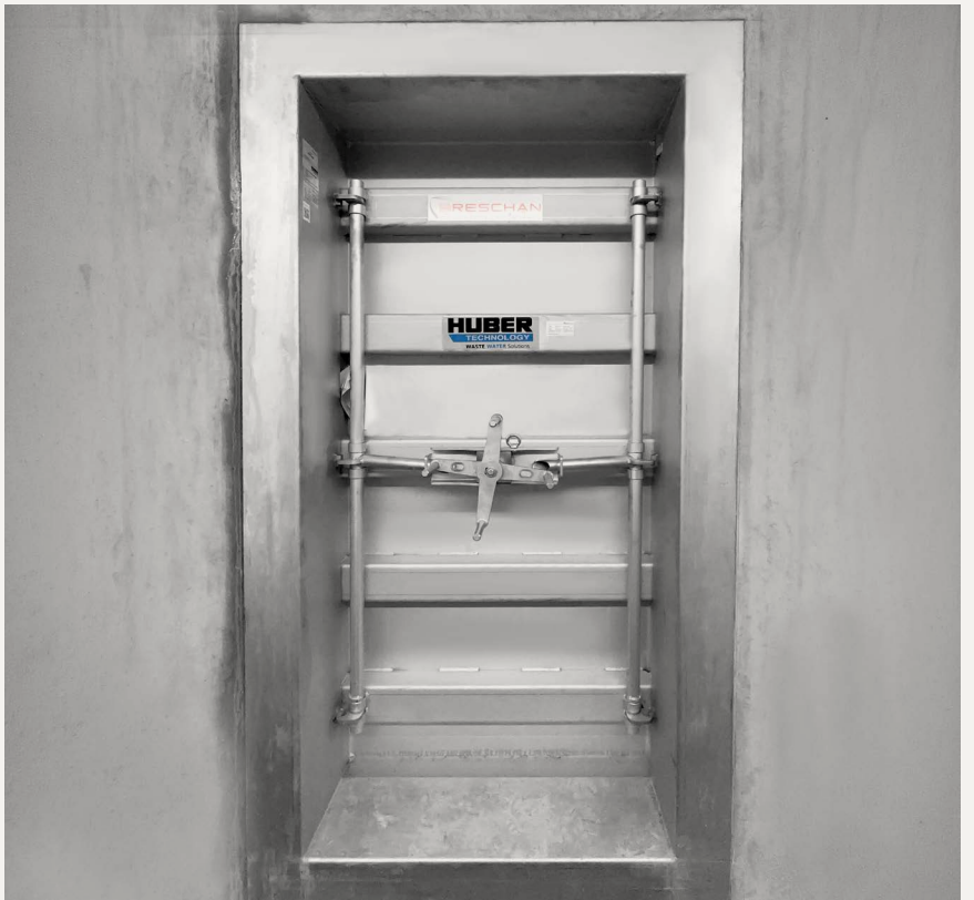
Auf der Kläranlage STEP d'Aire wurden 50 HUBER Drucktüren installiert.
