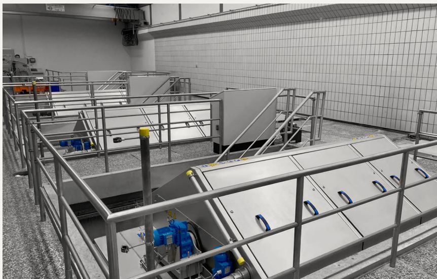
Die drei HUBER Scheibenfilter RoDisc® im Seewasserwerk Konstanz.
