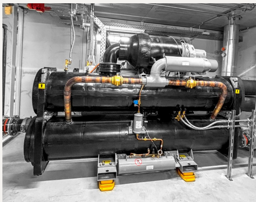
Die Großwärmepumpe in der Energiezentrale.
