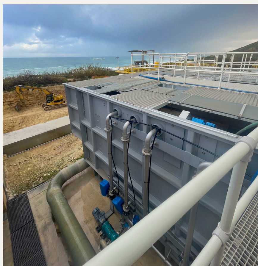
Blick auf den HUBER Tuchfilter RotaFilt®. Im Hintergrund laufen bereits die Bauarbeiten zur Erweiterung der UF-RO Anlage.
