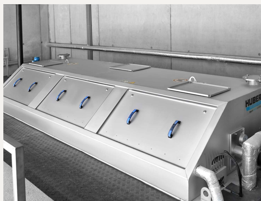
HUBER Trommelsieb LIQUID auf der ARA Saalbach.
