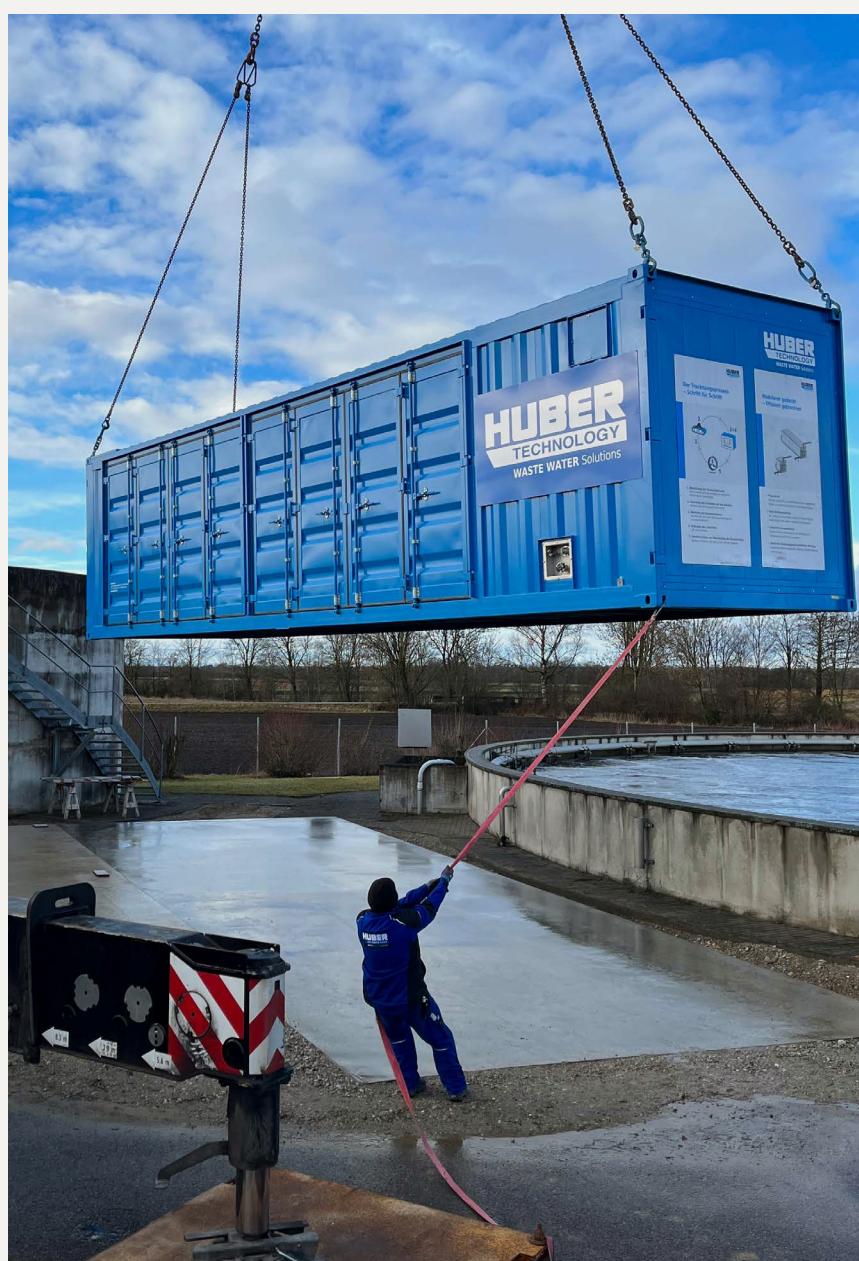
Der Kaltlufttrockner kann per LKW transportiert und per Autokran platziert werden.
