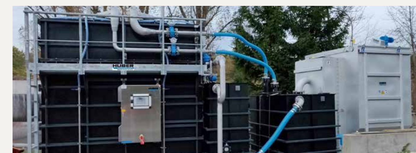
Die ersten Testreihen der Wasseraufbereitungsanlage fanden auf der Kläranlage in Spalt (Bayern) statt.
