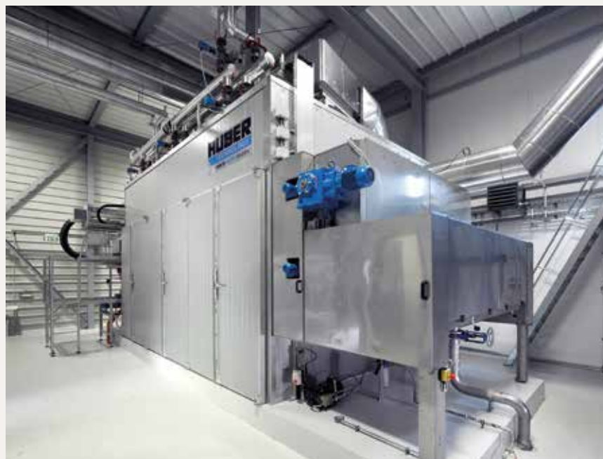
HUBER liefert für dieses Großprojekt zwei Bandrockner BT der Baugröße 30 als Komplettsystem inklusive der Zubehörteile.
