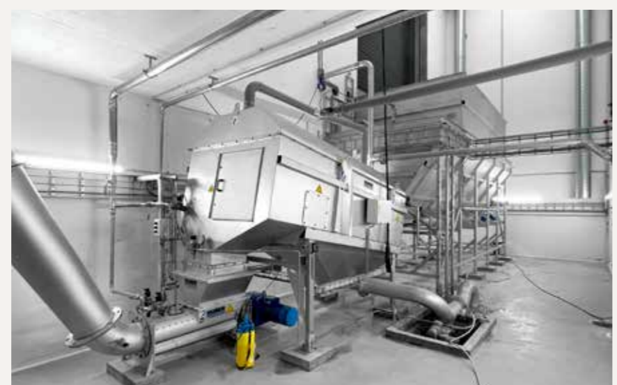
Drei HUBER Schneckenpressen Q-PRESS® zur Entwässerung des Schlammes.
