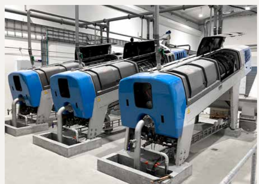
Annahme, Siebung und Entwässerung mit HUBER Annahemunker RoSF7, Waschtrommel RoSF9 und Waschpresse WAP®.
