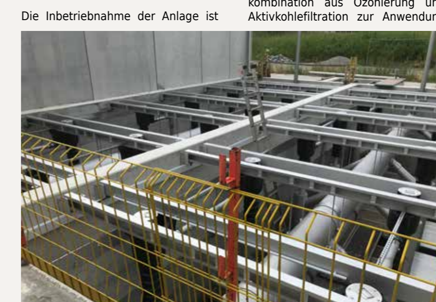
In Uhldingen wurden die 24 HUBER Aktivkohlefilter CONTIFLOW® GAK bereits im Sommer installiert.
