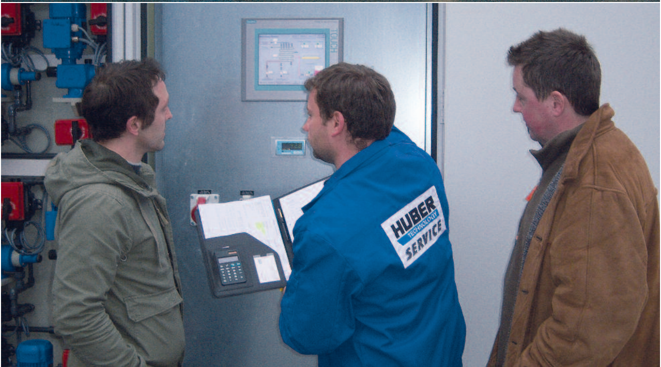
HUBER Service bei der Überwachung und Steuerung einer Abwasserreinigungsanlage – Unterstützung und Schulung des Betriebspersonals vor Ort
