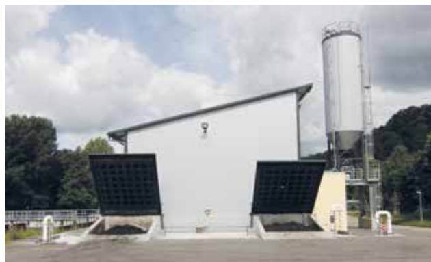
Armazenagem de lodo e silo de material seco.
