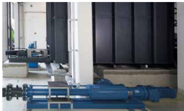
Armazenagem de lodo e bomba.
