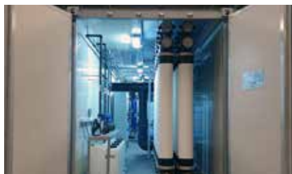
Etapa de pré-tratamento usando ultrafiltração para remoção de suspensões.
