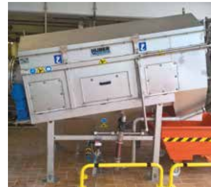
Lavagem de areia contaminada com a versátil RoSF9 HUBER de tambor de lavagem.
