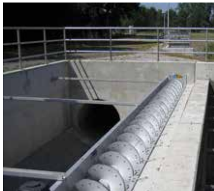
Tela de águas pluviais ROTAMAT® RoK1 HUBER instalada no lado seco da barragem de transbordamento.
