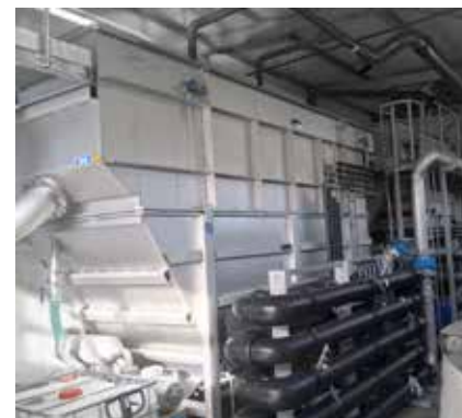
Estação de flotação por ar dissolvido HDF HUBER para redução de sólidos e graxa antes da descarga indireta.
