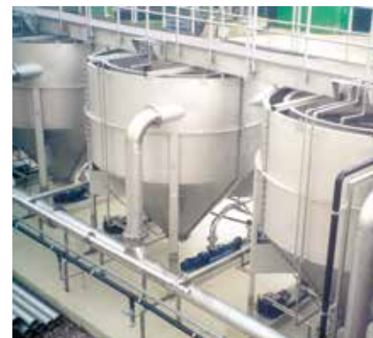
Coletor de areia circular HRSF HUBER em operação.
