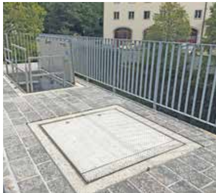
Tampa da abertura de inspeção SD7 HUBER do rolamento de carga.
