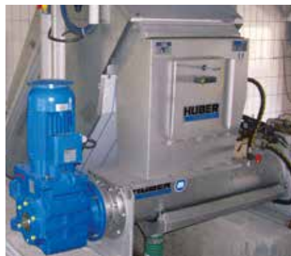
Prensa de lavagem WAP® HUBER instalada atrás de uma tela fina STEP SCREEN® HUBER.
