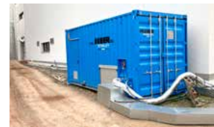
Aluguel de instalações para pré-tratamento de águas residuais na indústria de laticínios, com capacidade aprox. de 15 m³/h.
