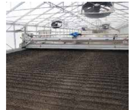
O lodo de clarificação desidratado torna-se um granulado de lodo seco e estável.
