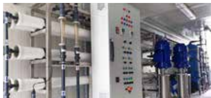
Etapa pós-tratamento para remoção de salinidade.
