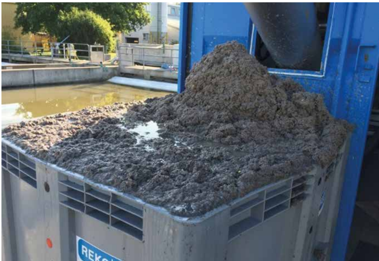
Resíduos separados pela peneira de tambor LIQUID HUBER: A carga a ser manuseada no estágio de tratamento biológico é reduzida e mais gás pode ser produzido no digestor.
