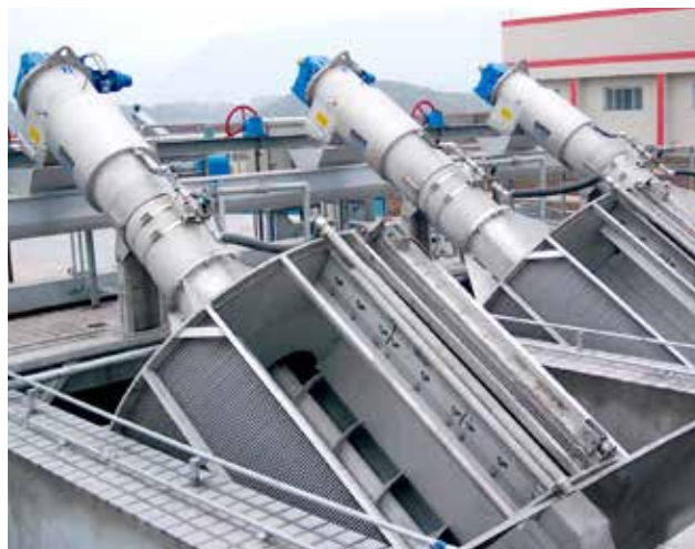
Várias unidades paralelas de peneira fina ROTAMAT® Ro1 HUBER instaladas no canal.
