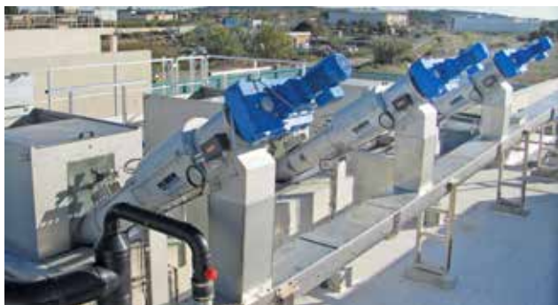
3 unidades ROTAMAT® STAR tamanho 1000 com perfuração de 1,5 mm protegendo a instalação de lodo ativado de membrana a jusante.
