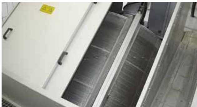
Peneira fina de tambor rotativo ROTAMAT® HUBER instalada no canal com uma tampa móvel de aço inoxidável, tamanho 600 a 3.000.
