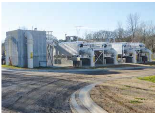
4 unidades de filtro de disco RoDisc® HUBER com 18 discos instalados em um tanque de concreto.
