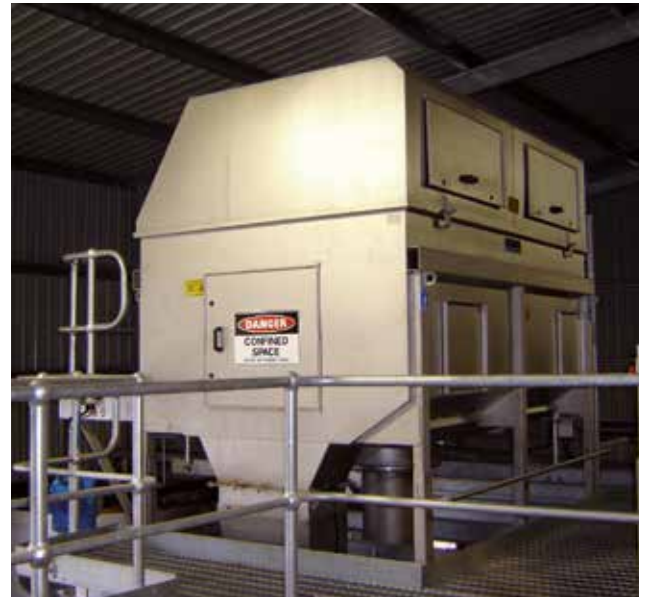
Instalação de uma peneira de tambor RoMesh® HUBER para o tratamento de águas residuais industriais.
