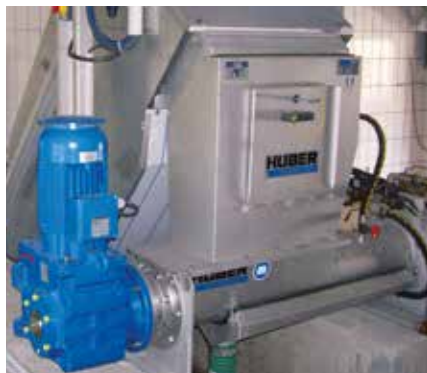
HUBER prací lis WAP® nainstalovaný za zařízením HUBER jemné česle STEP SCREEN®.
