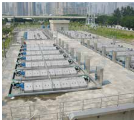
24 instalovaných jednotek HUBER RoDisc®.
