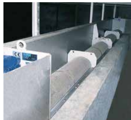
HUBER čištění na přepadech ROTAMAT® RoK2 instalované na znečištěné straně přepadu.
