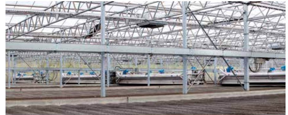
Paralelní provoz jednotek HUBER Sludge Turner SOLSTICE®.
